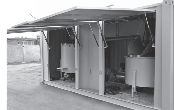
Рис. 3 Система фасадных дверей станции
